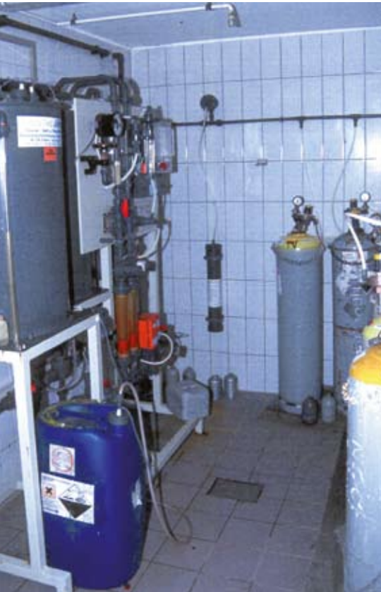
Bild 5: Natriumchloritlösung im Chlor-/Chlordioxidverfahren
